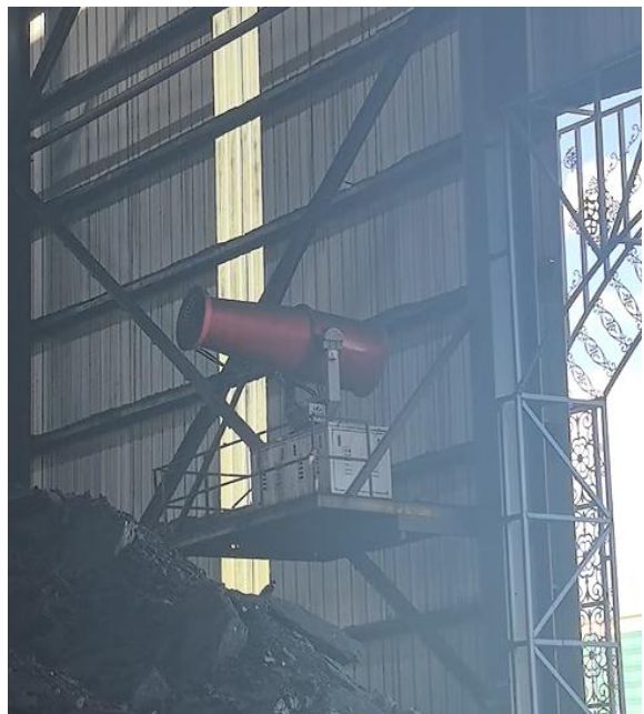
原煤和中煤储棚内雾炮机
