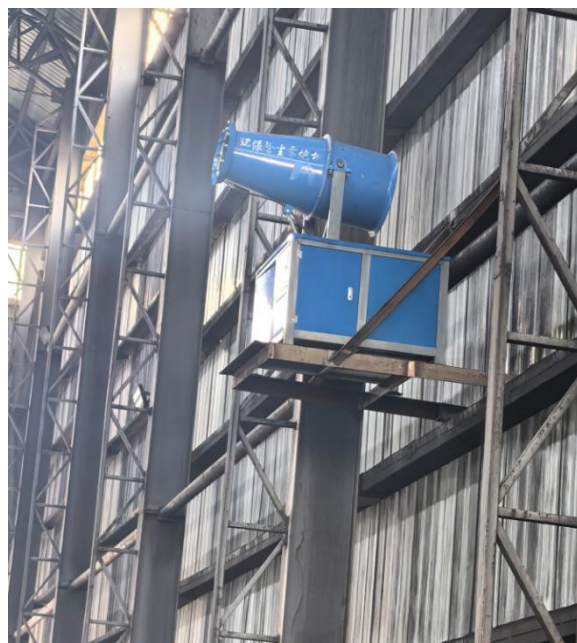
精煤棚内雾炮机
