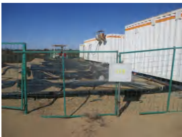
生活污水暂存池
