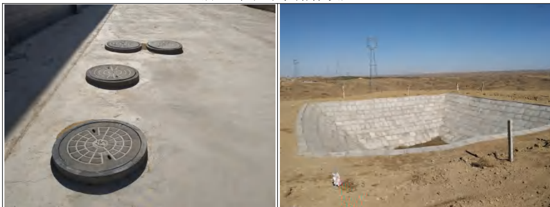
刘家梁站污水储存设施
