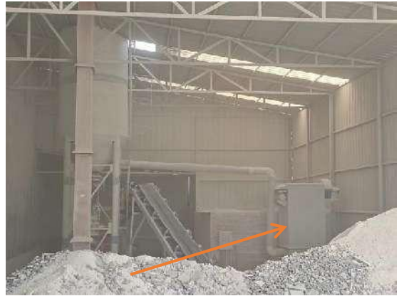
上料口收尘器
