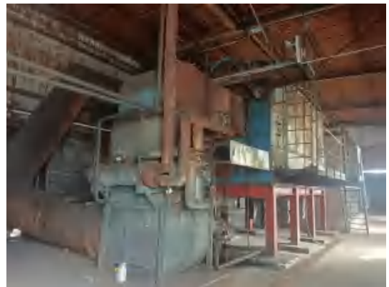
活化 10t/h 余热锅炉
