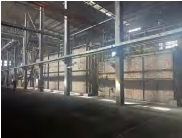
5#炭化炉、焚烧炉、余热锅炉
