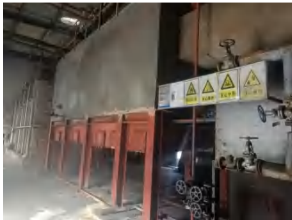
活化 4t/h 余热锅炉
