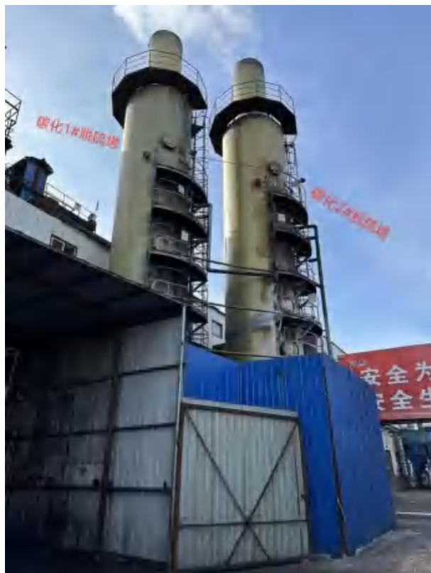
2 台炭化脱硫塔
