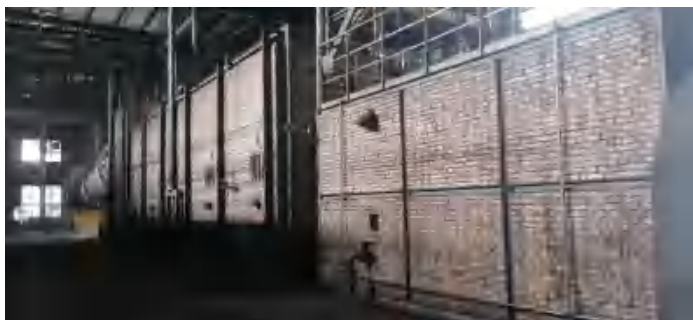
6#炭化炉、焚烧炉、余热锅炉
