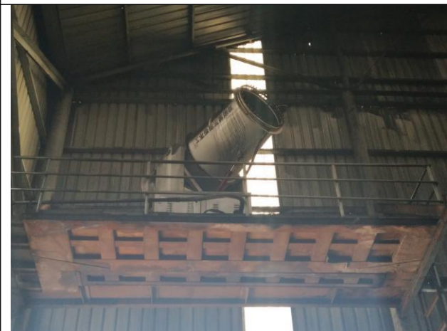
储煤棚内雾炮
