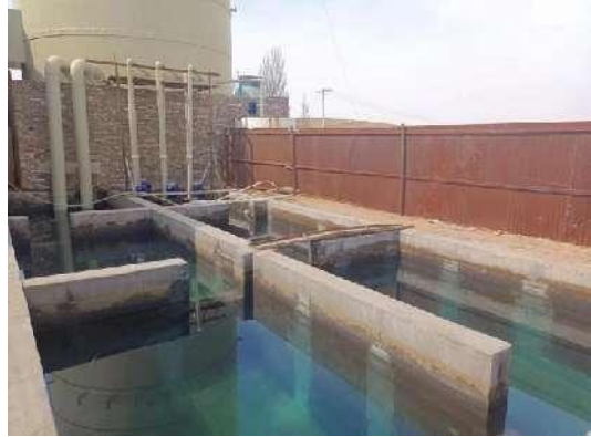
脱硫废水 6 级沉淀池
