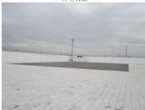
预留压缩机区
