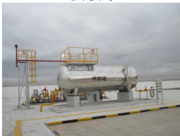
甲醇罐区 (图左为阻火器)
