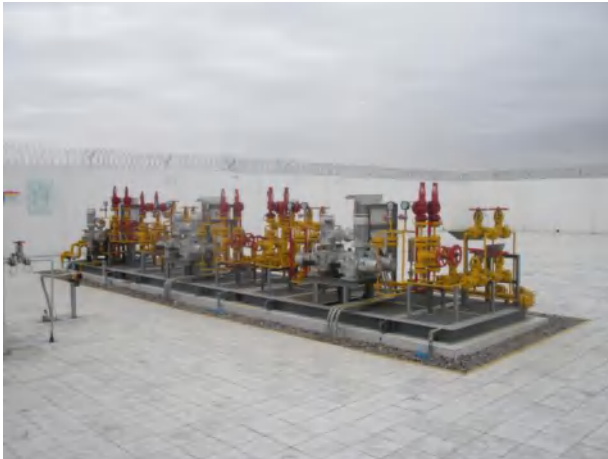
含硫天然气注醇一体化集成装置区
