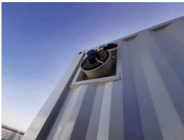
排风口活性炭气体净化装置
