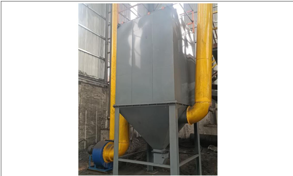
集尘罩、除尘设备、排气筒
