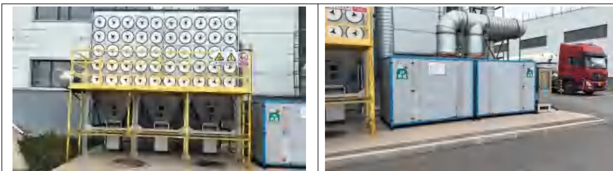
打磨废气风机及除尘器
