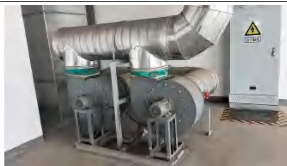
抽真空尾气风机
