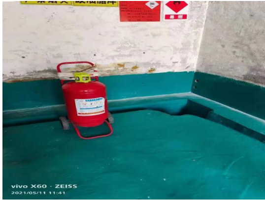
危险废物贮存库集油池
