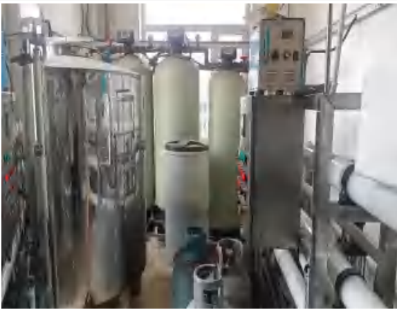
矿井水处理站
