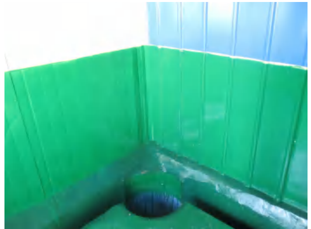
集液池及导流槽
