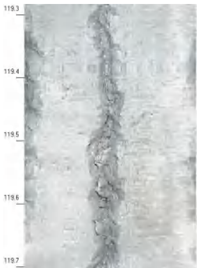
图 8.3-39 119.3/103.32m 深处垂向裂隙
