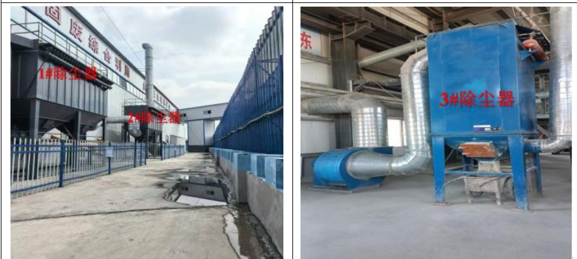
除尘器及排气筒
