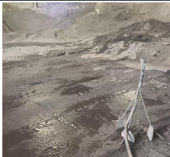
2250m 2 全封闭原料储棚内简易喷淋装置
