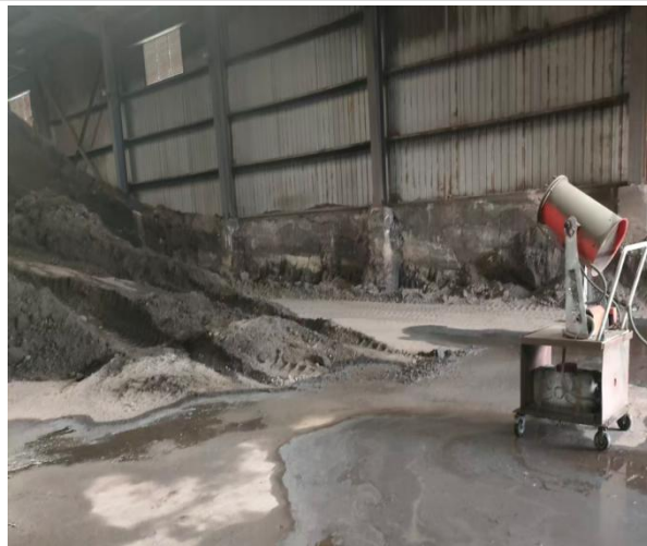
255m 2 原料暂存储棚内雾炮机
