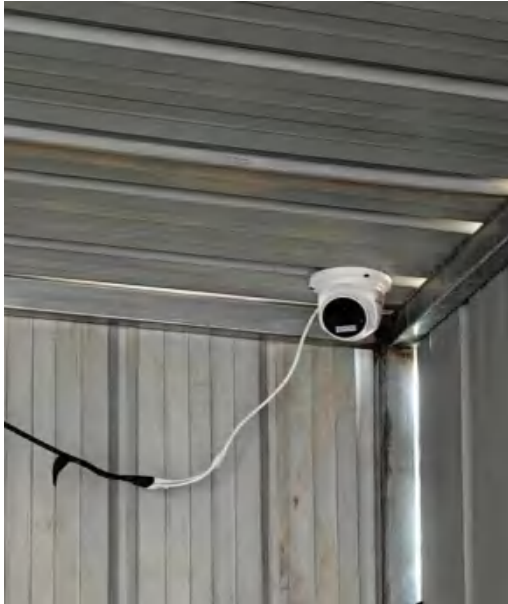
危废库内部监控
