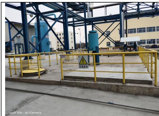
厂区北侧初期雨水收集池
