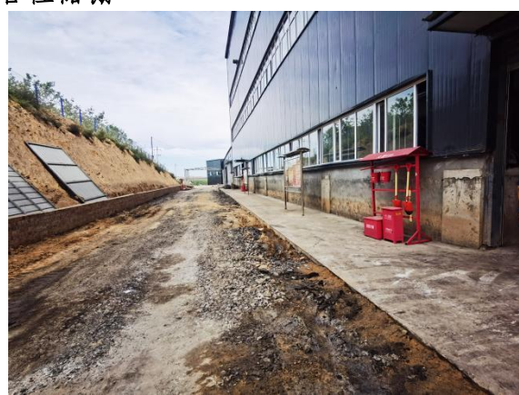
主厂房外消防站
