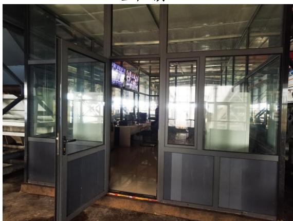
主厂房控制室
