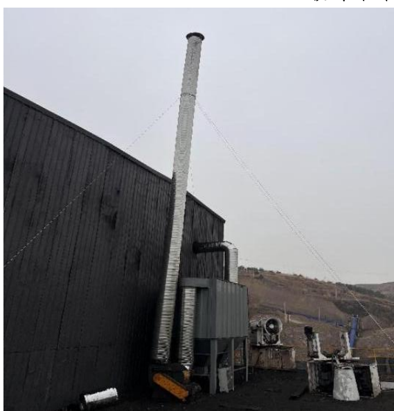
破碎站 16m 高排气筒
