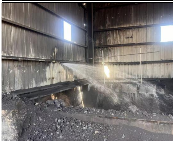
破碎卸料点喷淋设施
