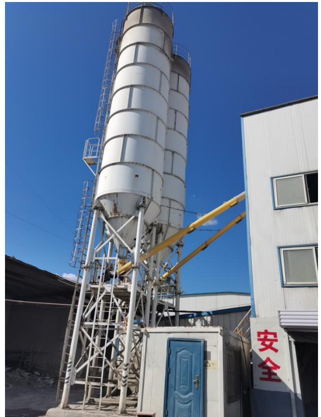
水泥、粉煤灰储料仓
