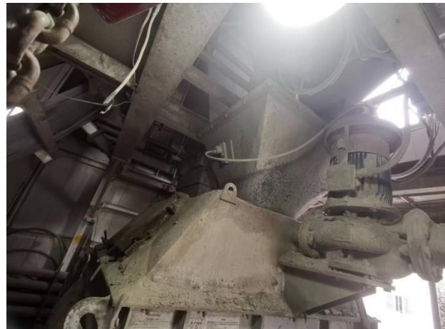
搅拌机除尘器
