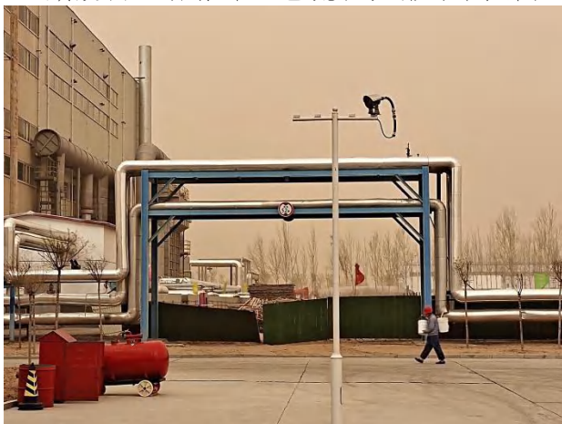
二期废菌丝暂存库监控设施
