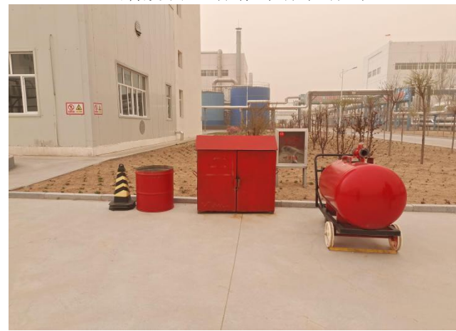
二期废菌丝暂存库消防设施
