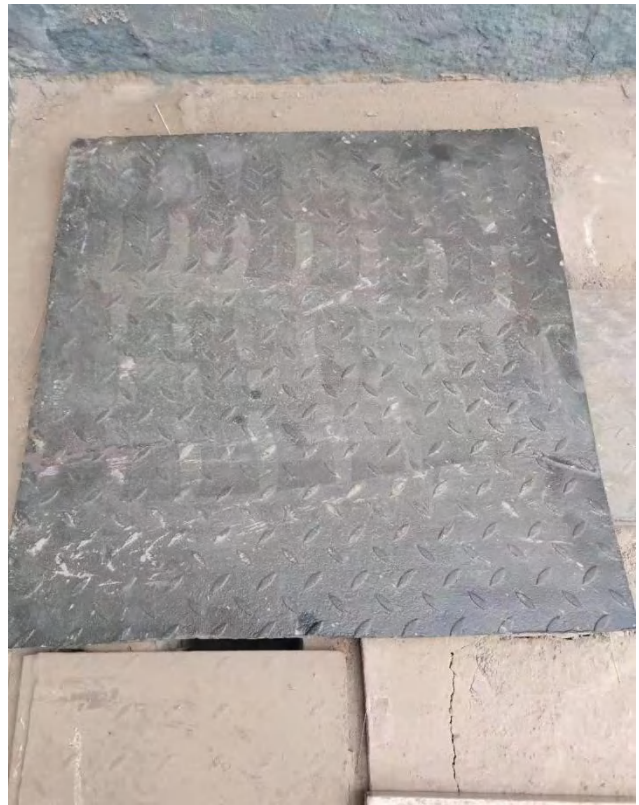
甲氨基危废暂存库收集池
