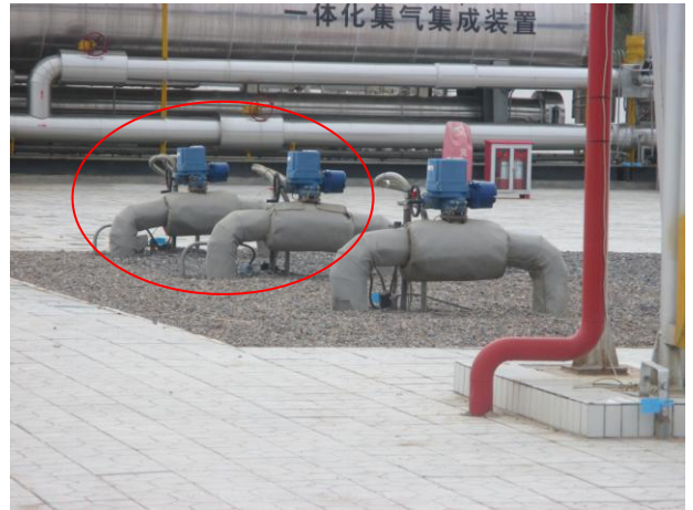
新建采出水外输泵 2 台
