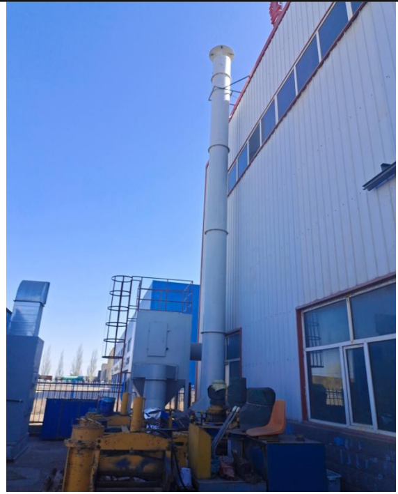
焊接烟气排气筒
