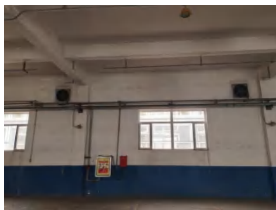
库内配有消防设施
