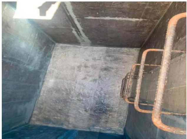
事故油池内情况
