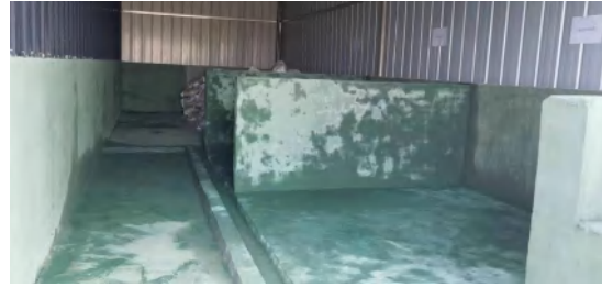
危废库内部分区堆放
