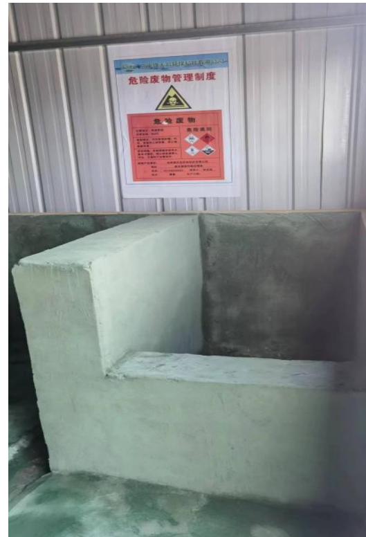
危废库收集池
