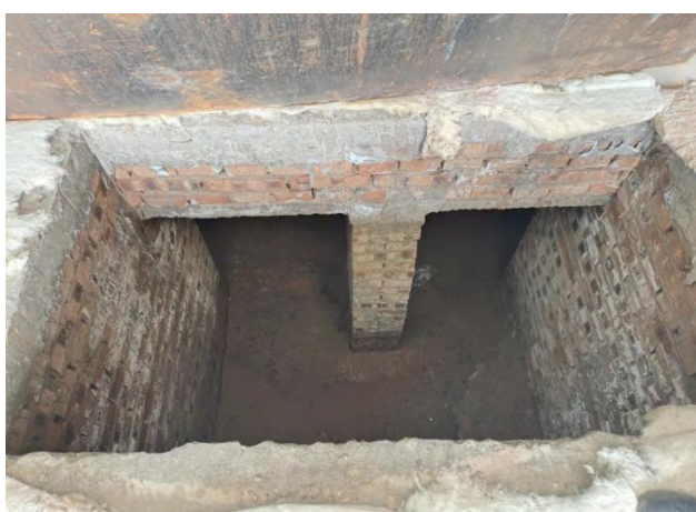
水浴除尘设施
