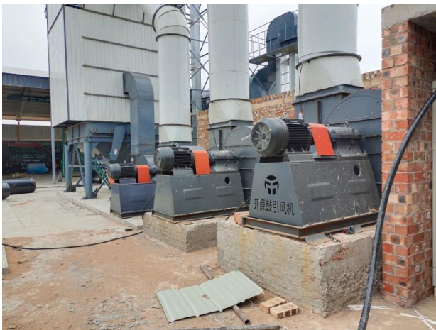
引风机（基础减震）
