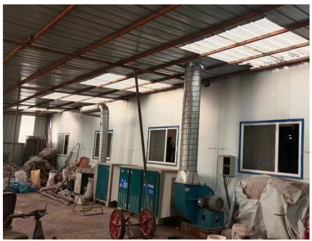
滴灌带生产线UV光解装置（原有工程）
