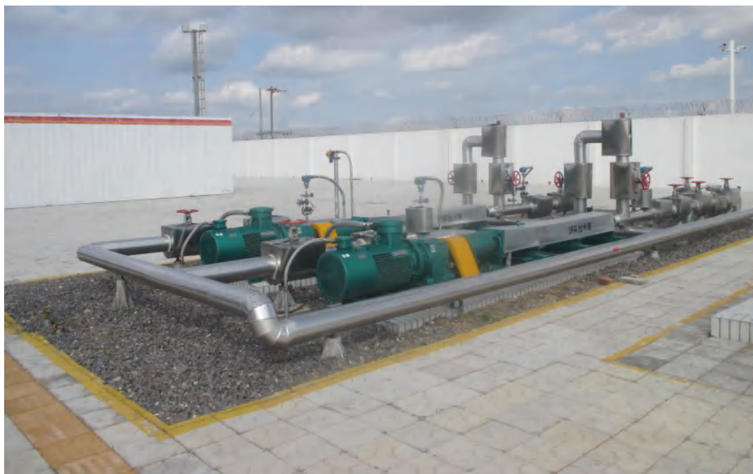
苏东 43 集气站气田采出水储罐附近设转水泵站一座，配套 2 台 22kw 的转水泵（1 用 1 备）
