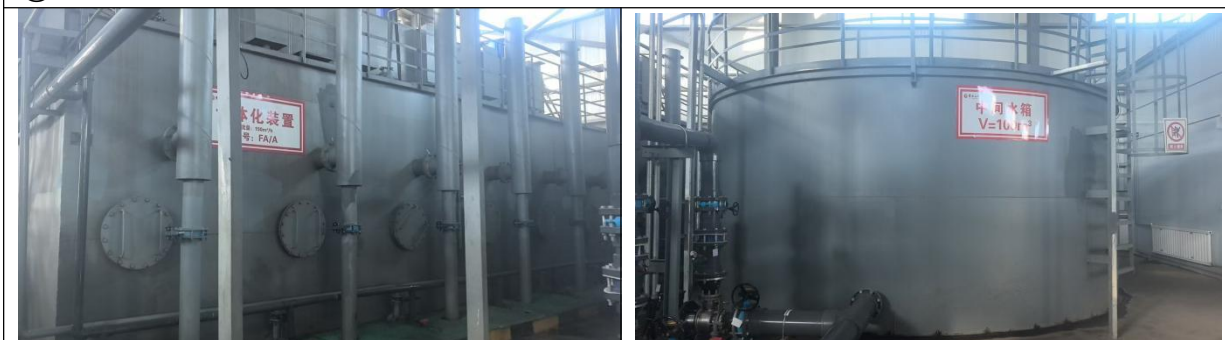
一体化处理装置
