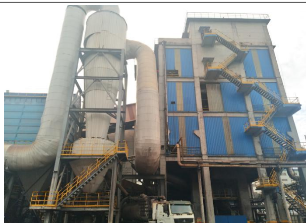
旋风除尘器和除尘灰暂存库
