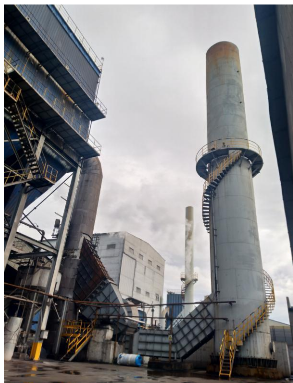
40m 高排气筒
