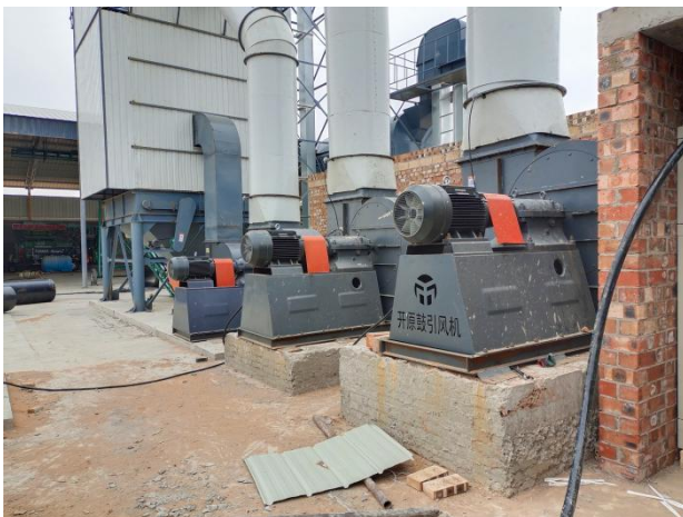
引风机（基础减震）
