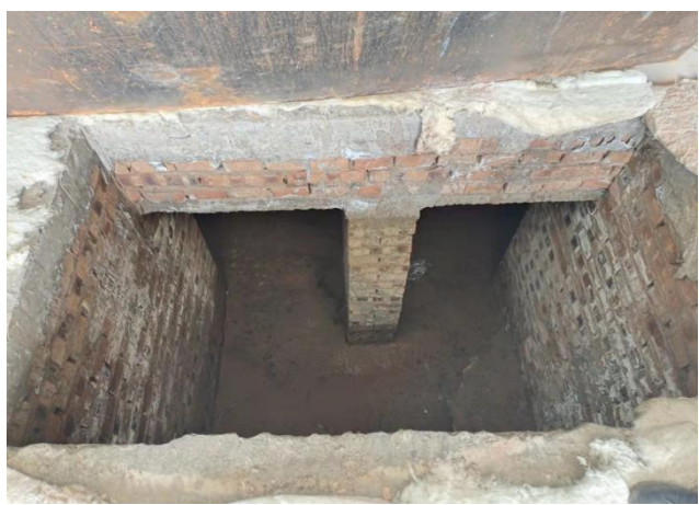
水浴除尘设施
