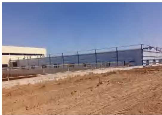
全封闭污水处理厂房
