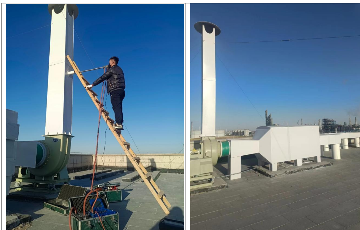
TF-1 废气治理设施及排气筒
