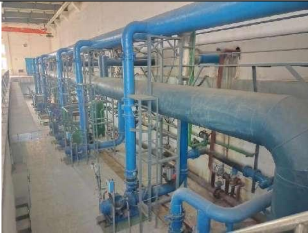
泵类设备置于地下
