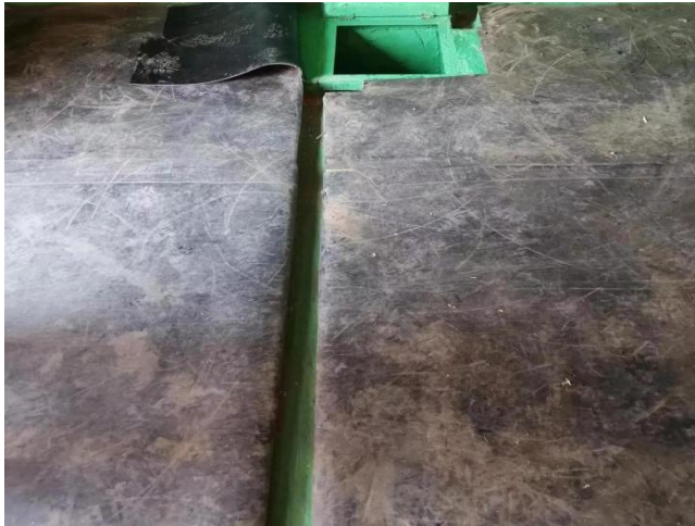
导流槽及收集池
