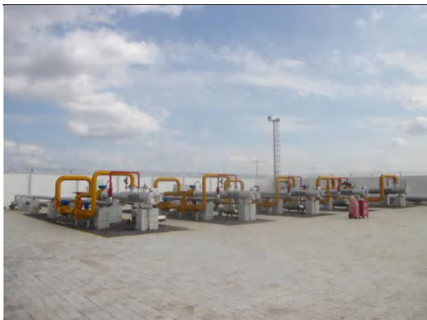
清管接收区及清管发送区
