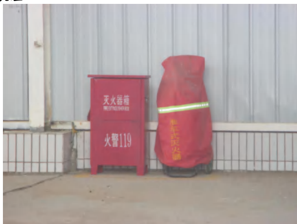
配备消防设施
