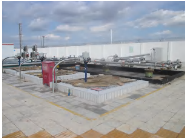
玻璃钢污水罐
