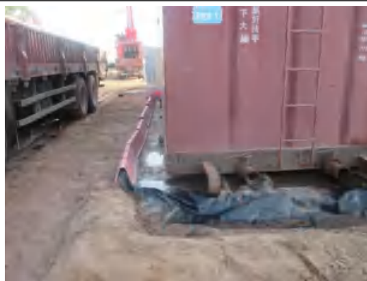
压裂液罐底部设置集液槽，建立有效围堰，底部铺好防渗膜。
