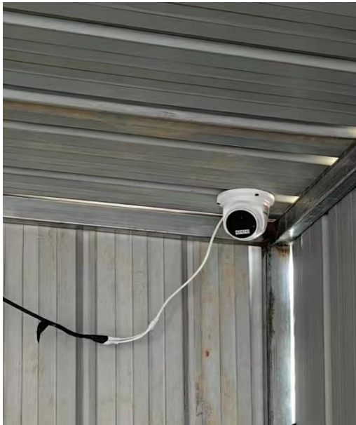
危废库内部监控
