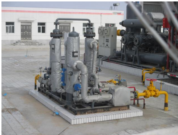
压缩机辅助设施
