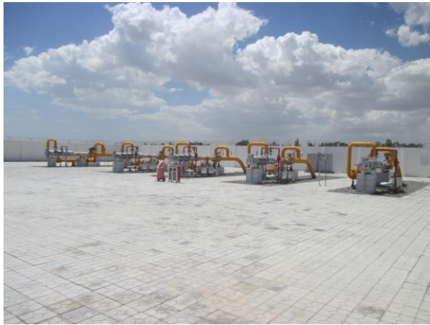
清管接收区及清管发送区
