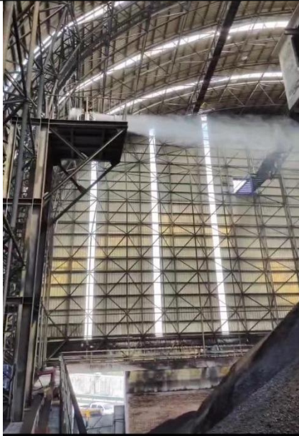
储煤棚雾炮降尘
