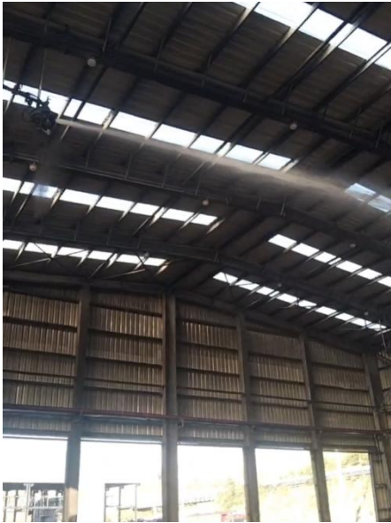
储煤棚消防炮
