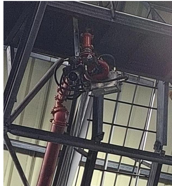
储煤棚消防炮
