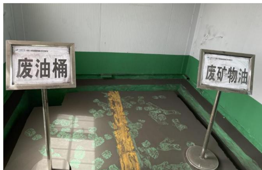
危废暂存库地面及分区
