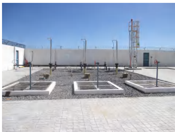
地埋式污水罐
