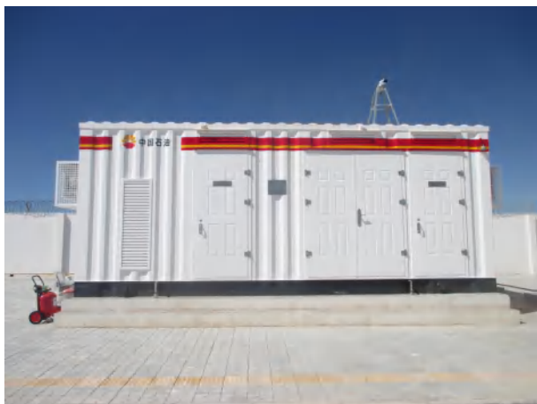
中低压集气站电控一体化集成装置
