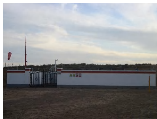
一处调气管线阀室投入运行
