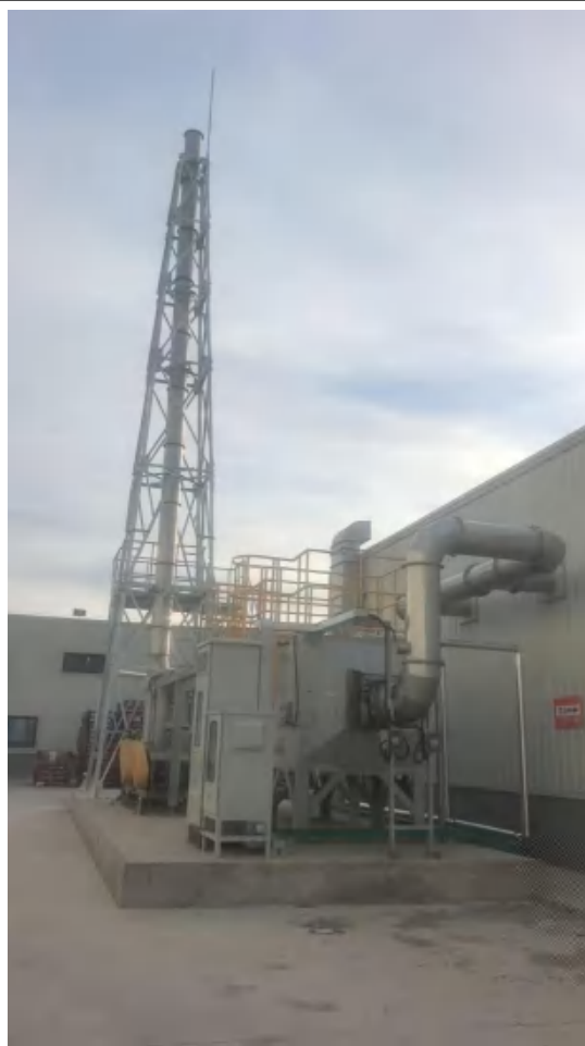
危废库废气处理设施及排气筒
