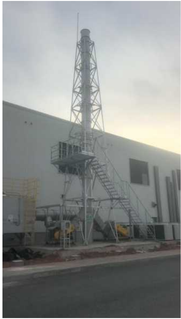
固化废气处理设施及排气筒
