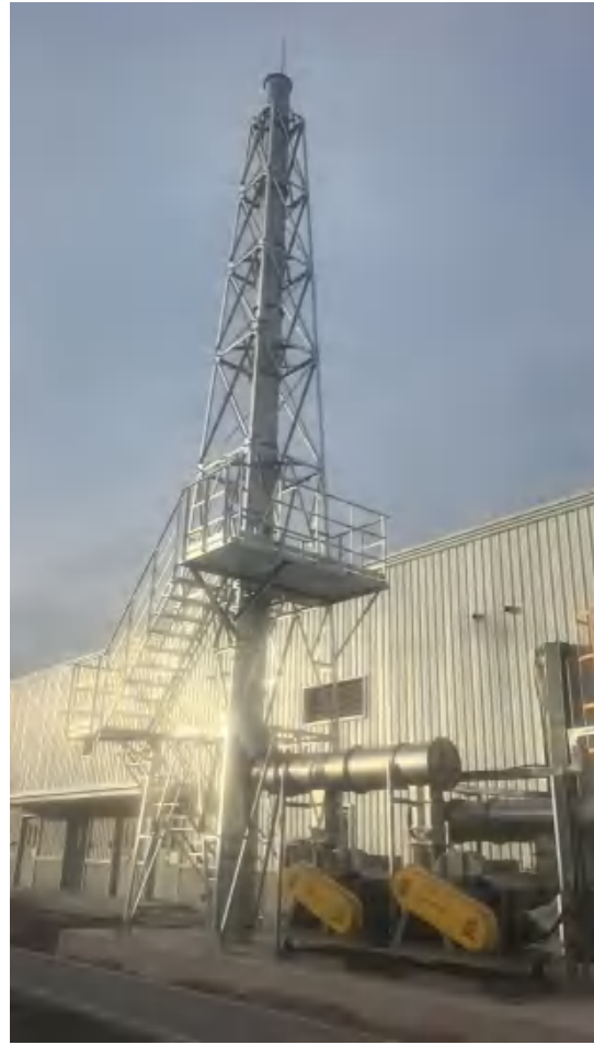
实验室废气处理设施及排气筒
