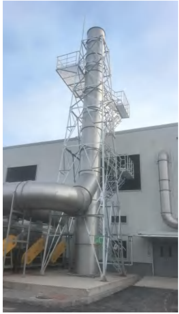
层压废气处理设施及排气筒
