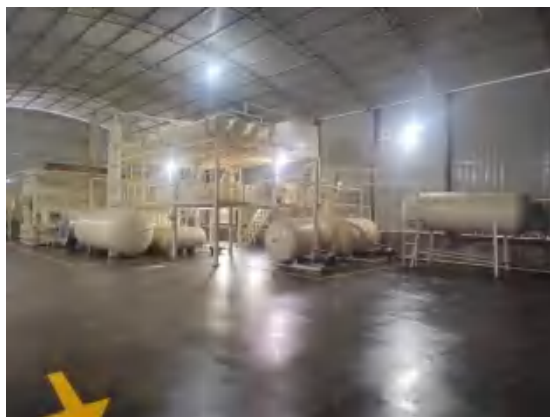
2#库废油处理设施
