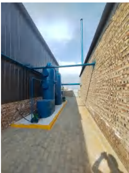
1#库废油处理设施喷淋塔
