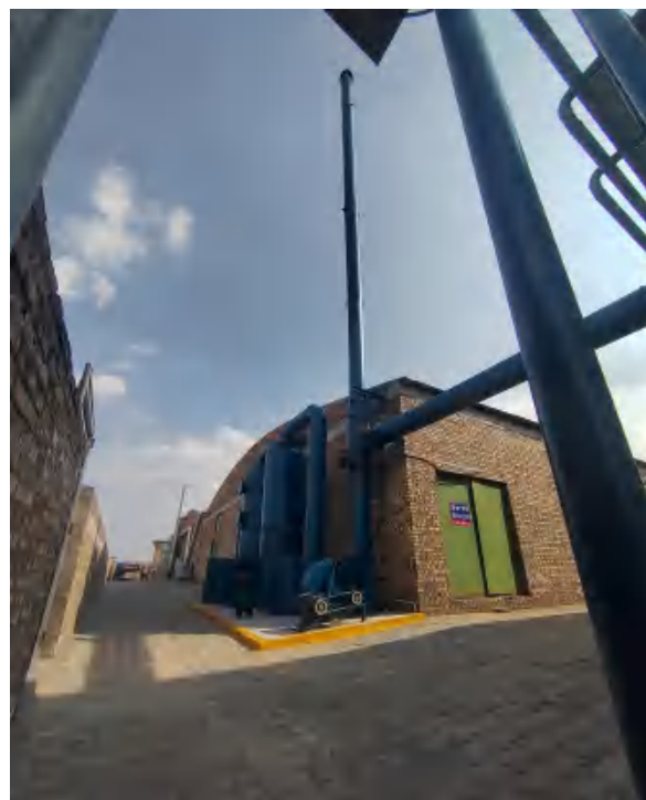
2#库废油处理设施喷淋塔
