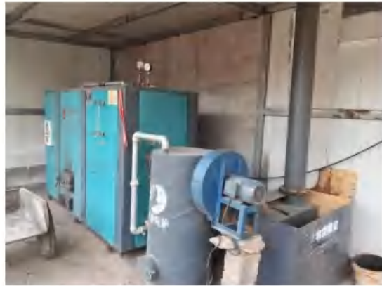
生物质锅炉及水浴除尘器
