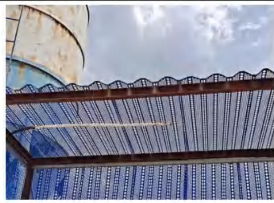
上料口喷淋设施
