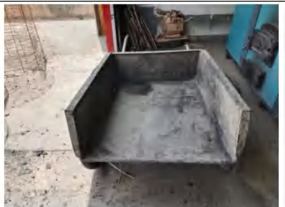
锅炉灰渣收集设施
